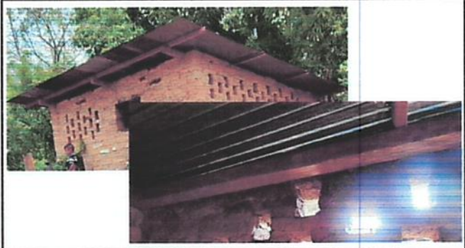
FOTO 4 ESTRUCTURA OXIDADA QUE YA CUMPLIO SU VIDA ÚTIL
